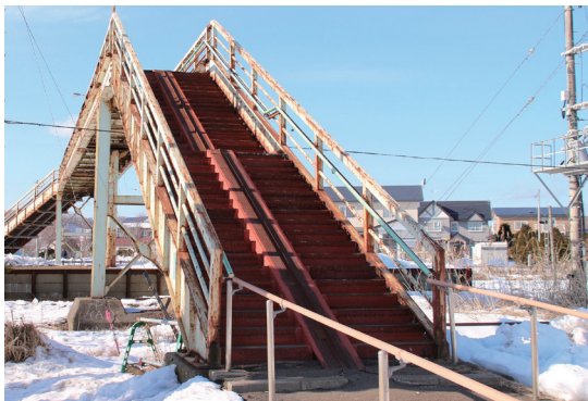
老朽化が進んでいる西庶路駅横の跨線橋
