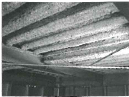
飛散が著しい吹付アスベスト (参考写真)
